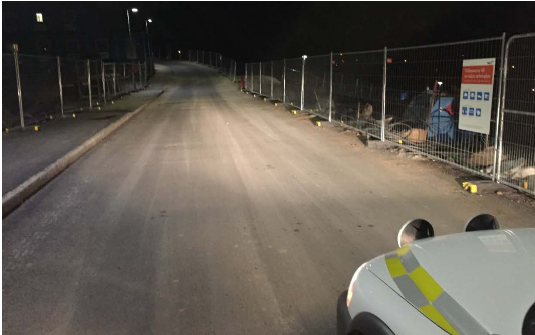
Figur 3 Gata utanför utfart från byggplats på Vimanshäll, Linköping.
